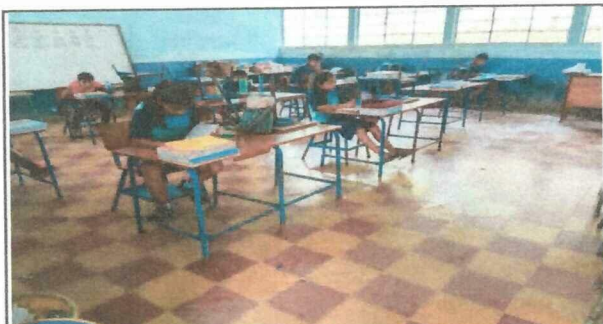
FOTOGRAFIA 3: SE PLANIFICO EL CAMBIO DE PISO CERAMICO YA QUE EL QUE TENEMOS SE ENCUENTRA EN MUY MAL ESTADO Y PODER TENER UN AREA MAS ADECUADA PARA LOS ALUMNOS
