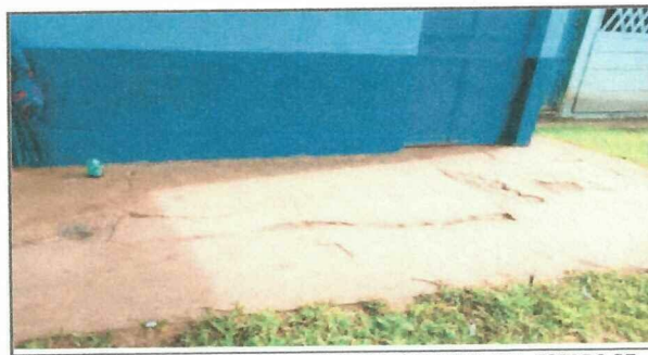
FOTOGRAFIA 6: CORREDOR DEL MODULO 2 EN MUY MAL ESTADO SE NECESITA REEMPLAZARLO YA QUE ES MUY PELIGROSO PARA LA INTEGRIDAD FISICA DE LOS ALUMNOS
