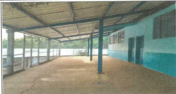
FOTOGRAFIA 1: SE EVIDENCIAN GRIETAS EN LOZA DE PATIO DE MODULO 1 Y SE NECESITA EL REMPLAZO DE LA MISMA YA QUE ES UN PELIGRO PARA LOS ALUMNOS
