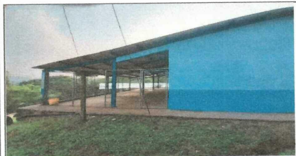
FOTOGRAFIA 5: BANQUETA LATERAL DE MODULO UNO EN MAL ESTADO SE NECESITA EL REEMPLAZO DE LA MISMA.
