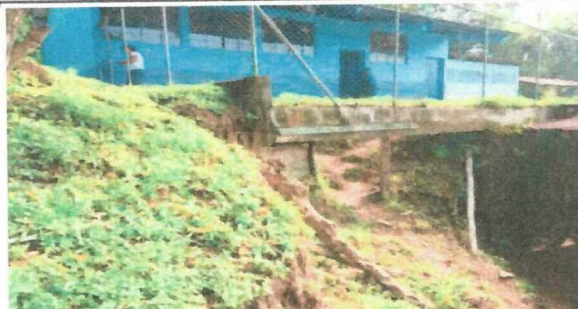
FOTOGRAFIA 2: SE NECESITA LA CONSTRUCCION DE UN MURO DE CONTENCIÓN EN EL SEGUNDO MODULO YA QUE ES AREA DE JUEGO DE NIÑOS Y REPRESENTA UN PELIGRO PARA ELLOS
