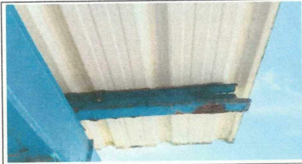
FOTOGRAFIA 4: SE NECESITA EL CAMBIO DE CONSTANERAS DE METAL YA QUE LAS QUE TIENE ACTUALMENTE UN PARTE DEL CORREDOR YA TIENEN MUCHA CORROSION.
